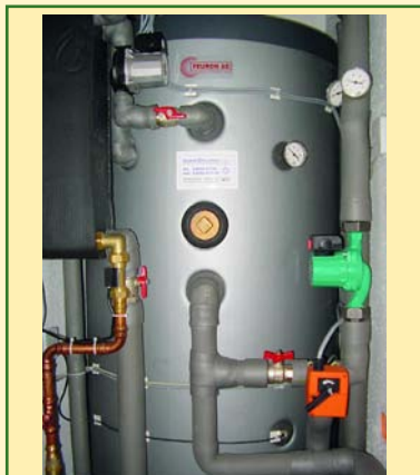
Brauchwasserspeicher mit hochwertiger Isolierung
